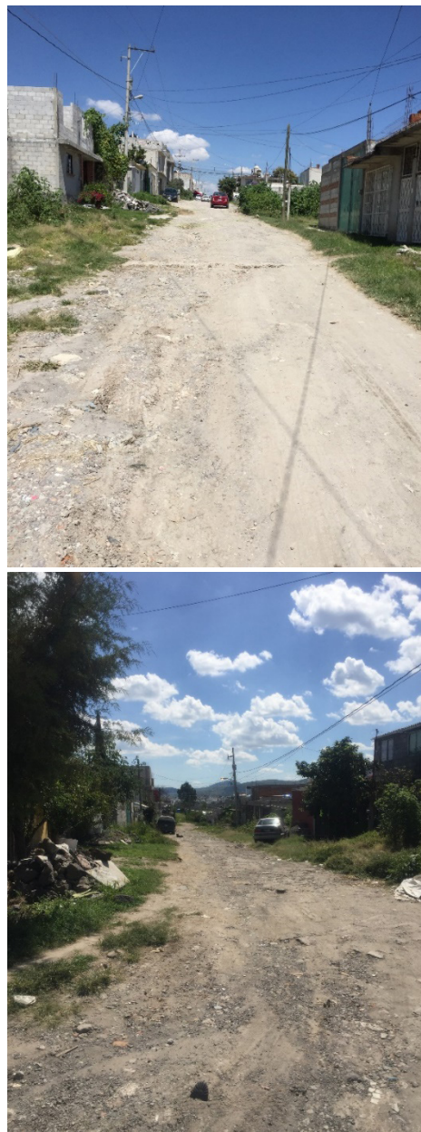
Figura 4. Ausencia de banquetas en la colonia.
