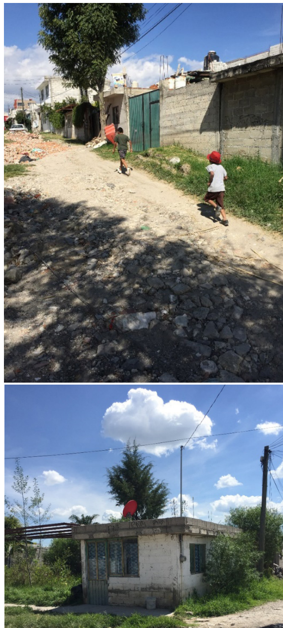
Figura 2. Estado actual de algunas calles de Valle del Paraíso.
